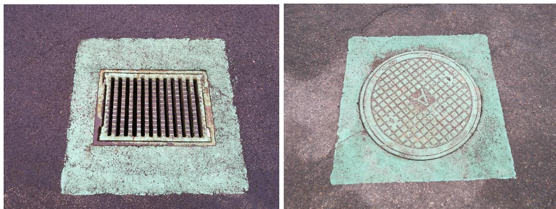
Figur 1. Rännstensbrunn kopplad till dagvatten.
